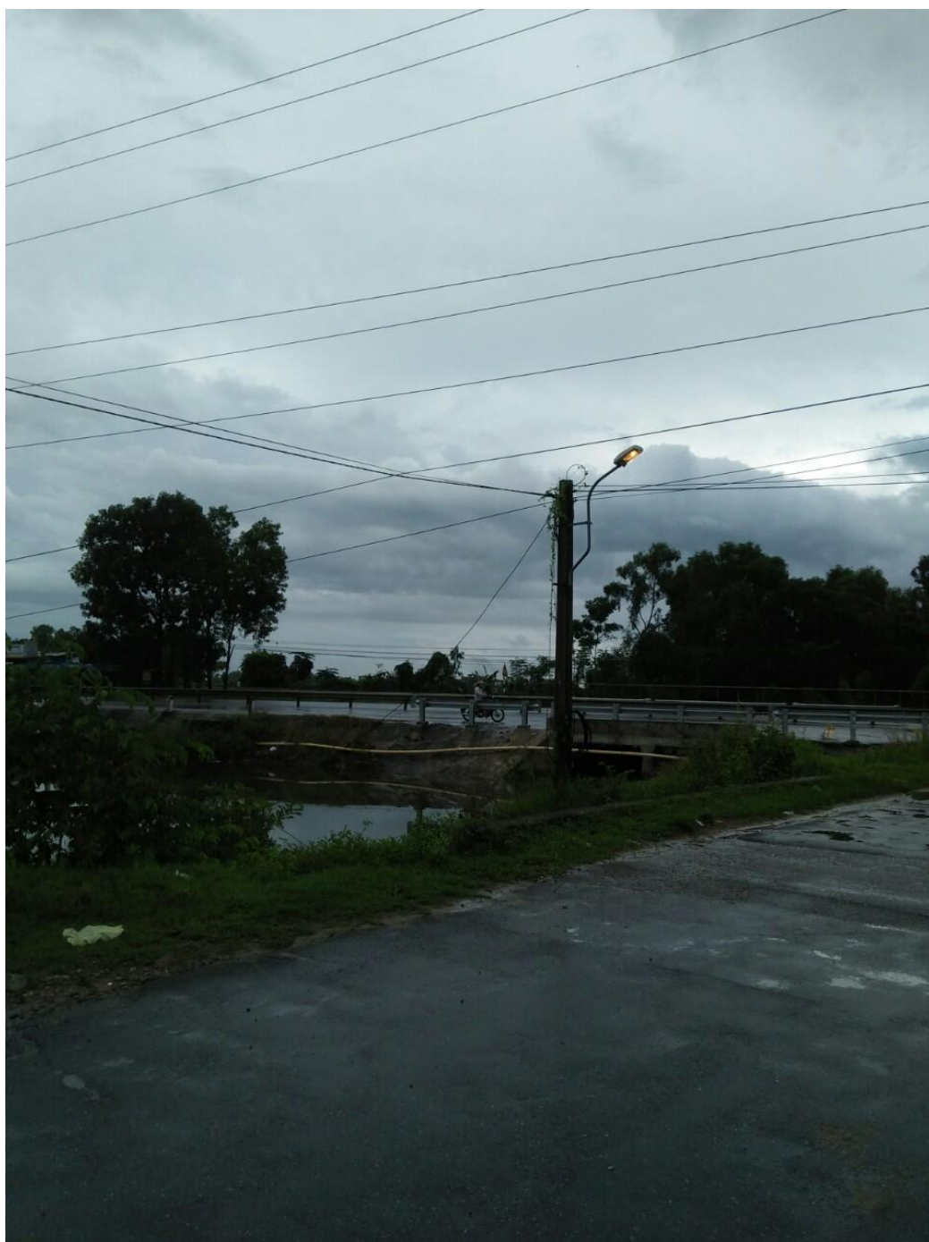
Hình ảnh Trụ đèn chiếu sáng đường Hoà Mậu
