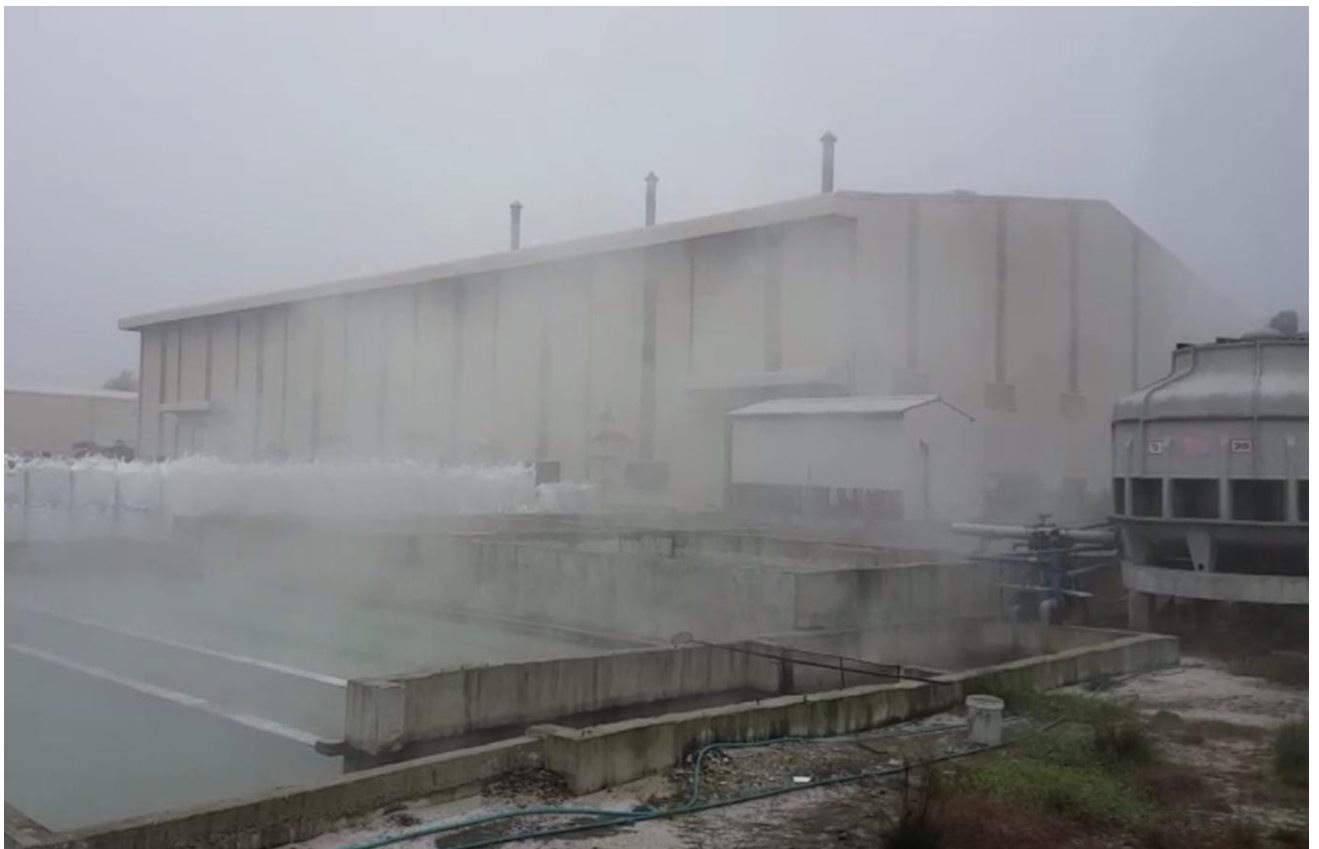
Ảnh chụp tại Bể nước làm mát tuần hoàn và bộ tháp quạt làm mát nước
