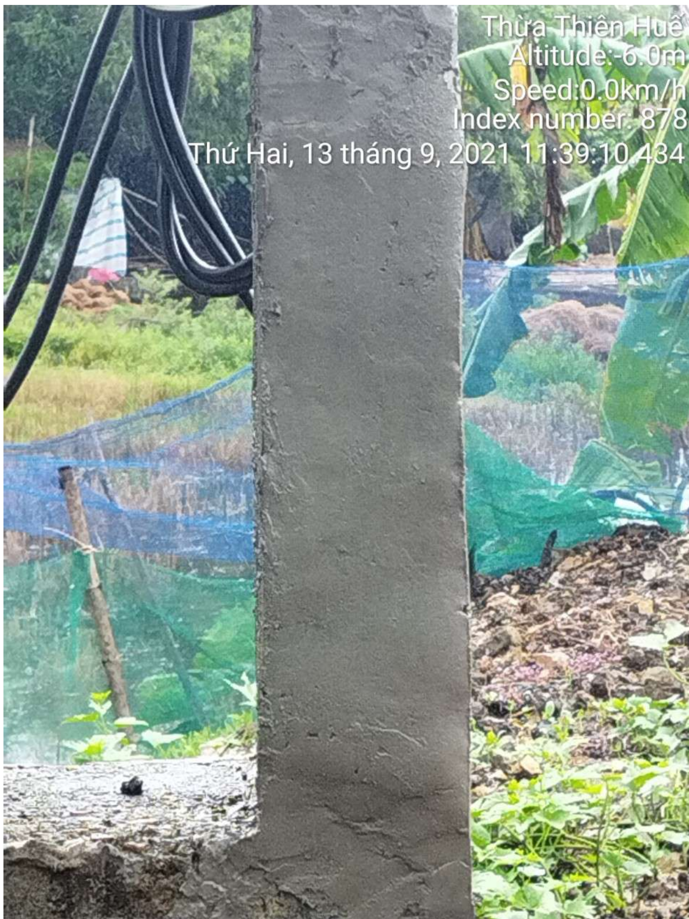
Hình ảnh sau xử lý tại vị trí cột 187/67/4 xuất tuyến 478 Huế 3
