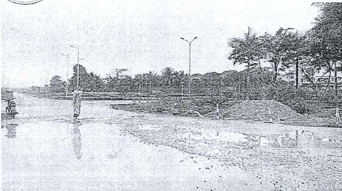
VỊ TRÍ ĐIỂN HÌNH ĐÀ THI CÔNG XONG CHƯA HOÀN TRẢ MẶT BẰNG
