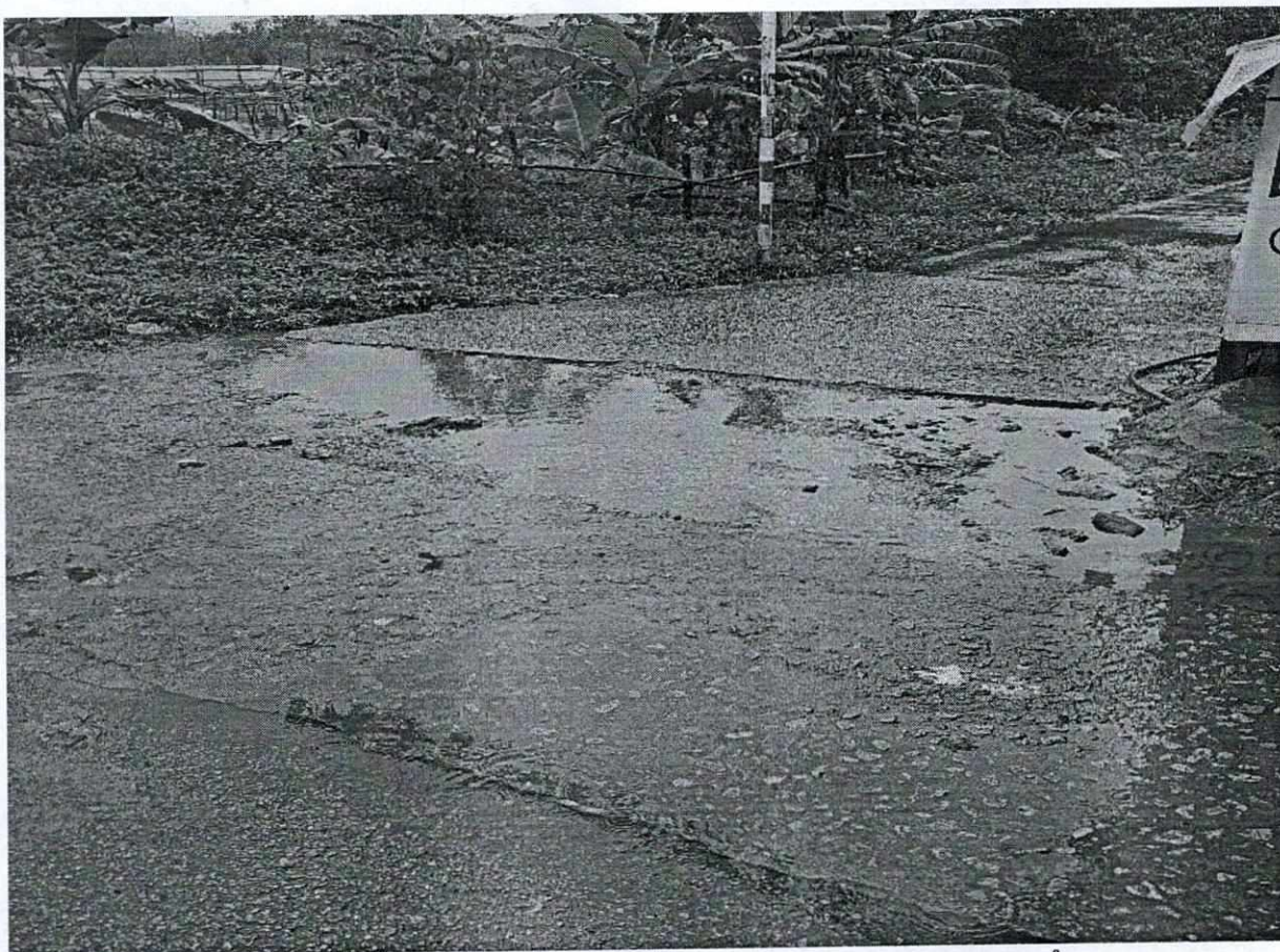
Hình ảnh đường cát xẻ không được lấp lại gây ứ đọng nước, tạo ổ gà gây nguy hiểm cho người, phương tiện tham gia giao thông
