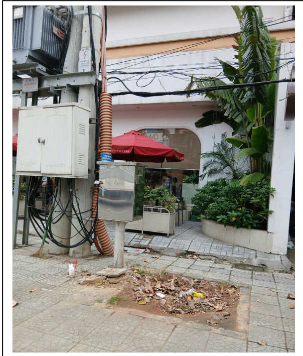
Ô trước số nhà 99 Trường Chinh sát trạm biến áp
